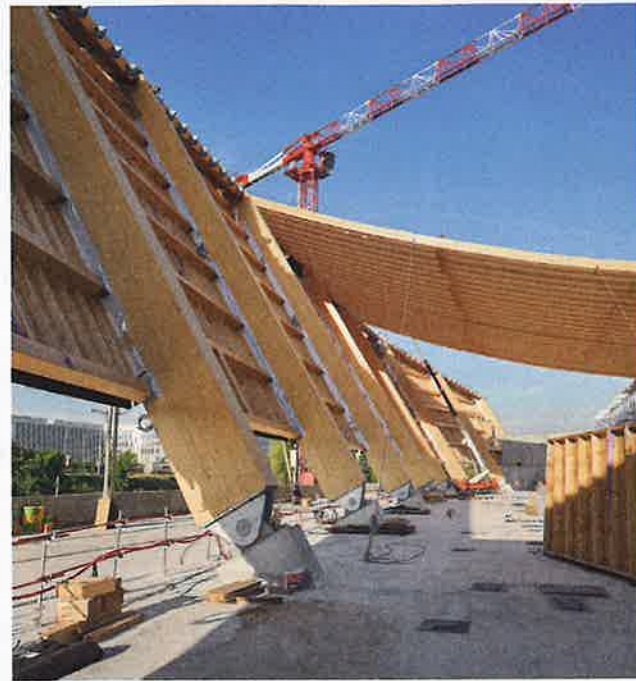
Chaque pièce métallique de liaison entre les poteaux béton et bois a été posée avec une précision millimétrique.
