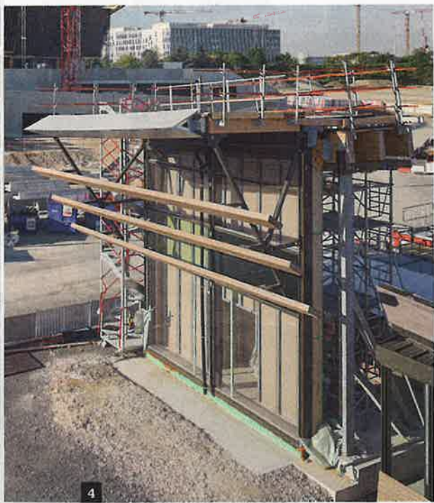
4 - Des façades rideaux en verre et métal habilleront les tympans est et ouest du bâtiment.
